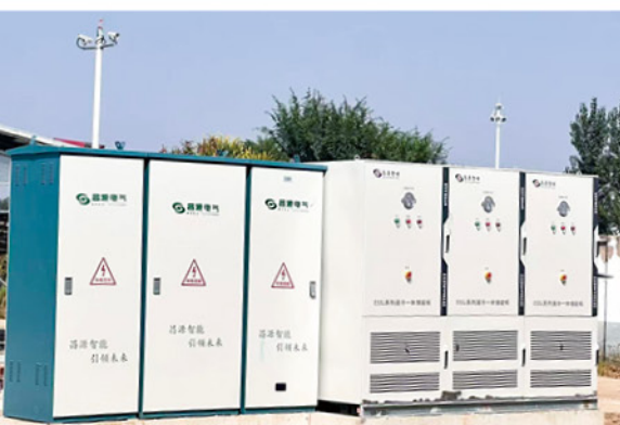
河北白洋淀服务区光储充充电站
