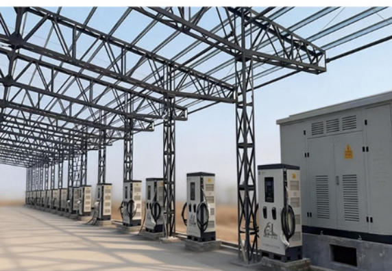
林州秒能重卡充电站
