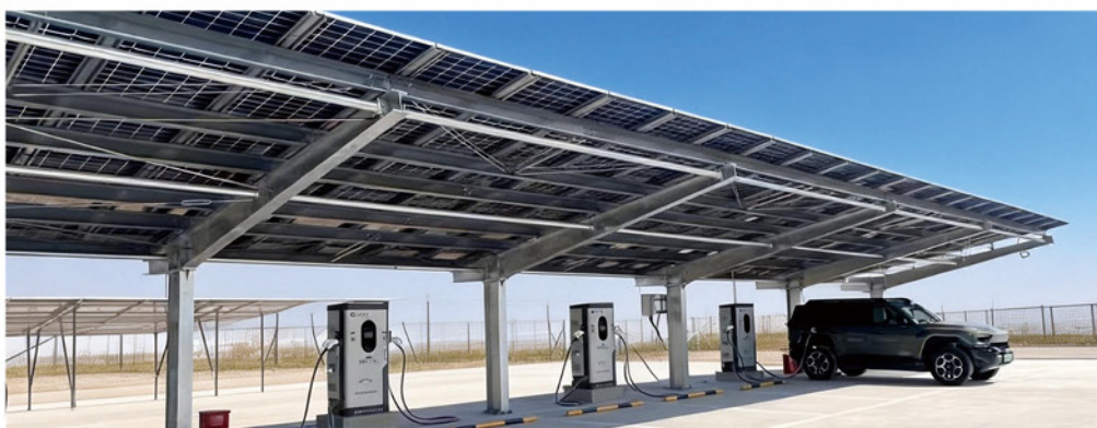
河北白洋淀服务区光储充充电站
