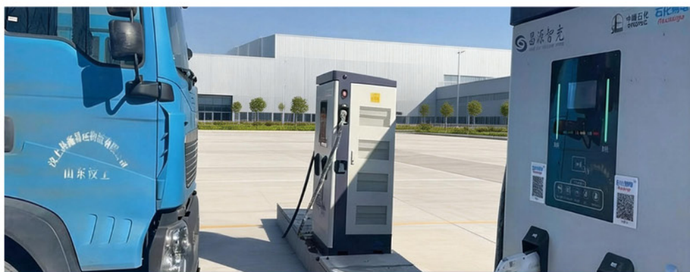
中国石化汶泗公路重卡充电站
